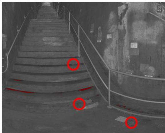
Rys. 5. Galeria Klimkówka. Na posadzce widoczne repery niwelacyjne (zaznaczone czerwonymi kółkami) i odsunięte metalowe przykrywki. (Zrzut z programu Z+F Laser Control)
